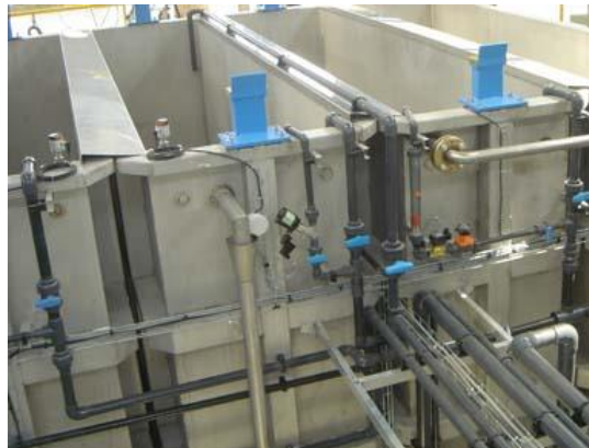
Traitement en immersion (train de cuve)
